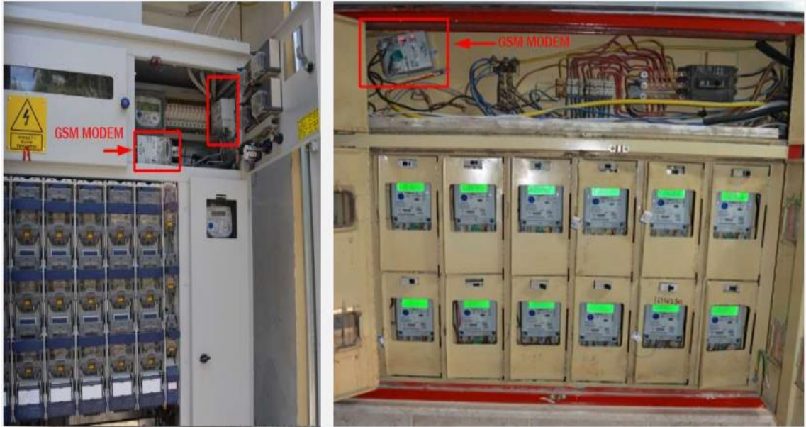
Şekil 3.9. Toplu sayaçların bulunduğu merkezi yerdeki PLC sayaç panosu (Elektrik Mühendisleri Odası, n.d.)
