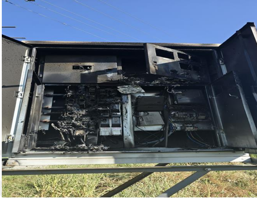
Şekil 2.2. Yanmış elektrik panosu içi
