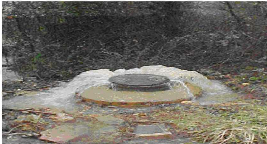
Şekil 1.17. Atık yağlardan dolayı tıkanan kanalizasyon Kaynak: (Öztürk, 2008)
